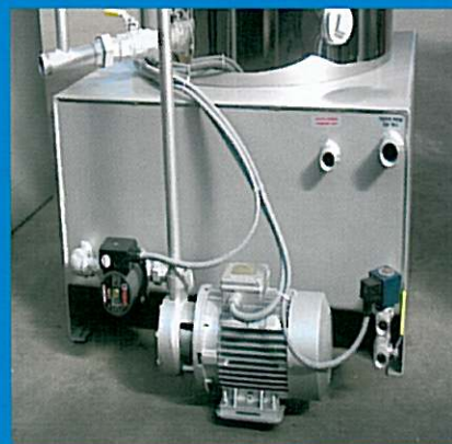
8-Condensate system 2: è un sistema che automaticamente innesca la pompa di alimentazione evitando il fenomeno della cavitazione in presenza di condense troppo calde.
